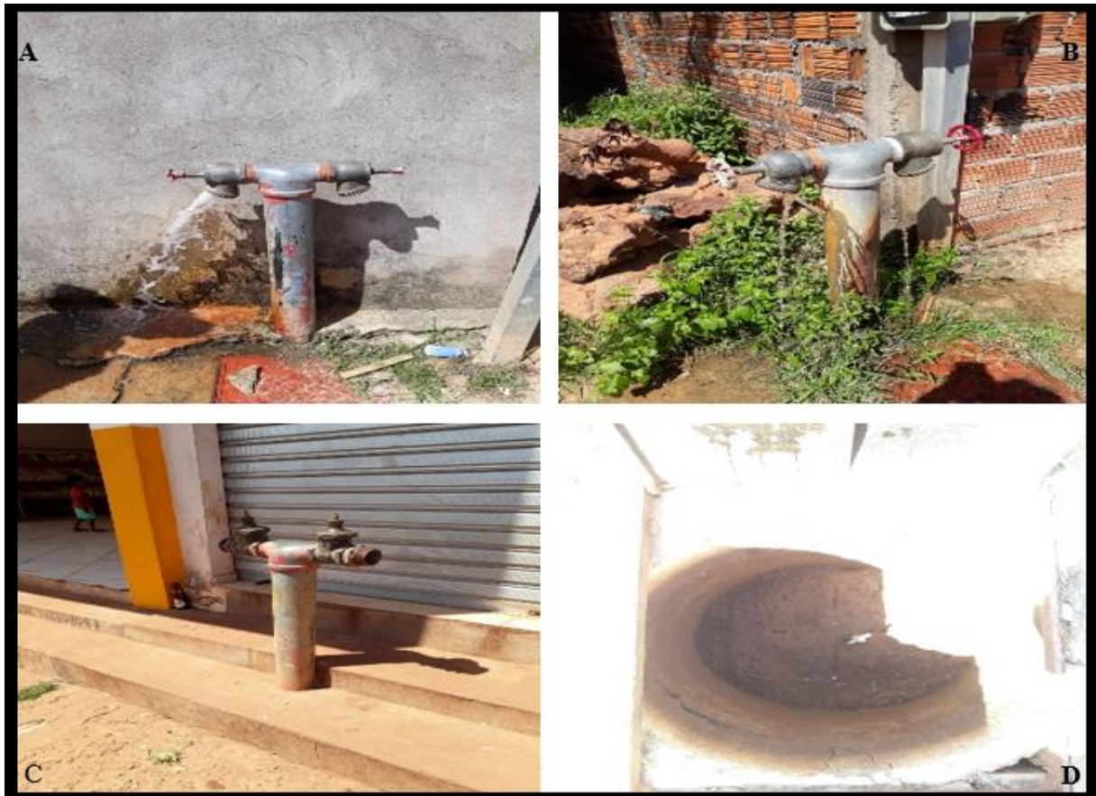
Figura 15 - Mosaico de fotografias evidenciando as condições dos hidrantes urbanos no Município de São José de Ribamar - MA
